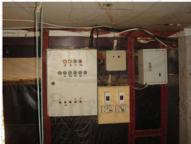
ภาพ 2.5 อุปกรณ์สัญญาณเตือน ประกอบด้วยอุปกรณ์เสริม แผงวงจรควบคุมพัดลมและปั้มน้ำ
