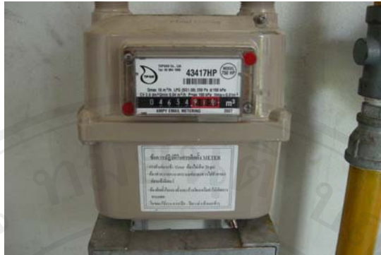
ภาพที่ ก6 มาตรวัดปริมาณการไหลของก๊าซแอลพีจี หน่วยวัดปริมาตรก๊าซหน่วยเป็นลูกบาศก์เมตร
