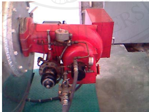
ภาพที่ ก2 หัว Burner oil preheater ยี่ห้อ Olympia
