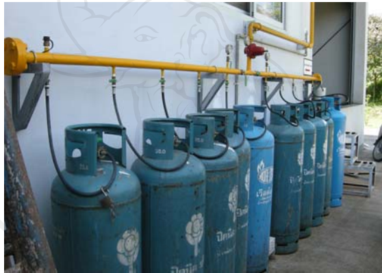
ภาพที่ ก7 สถานีก๊าซแอลพีจี
