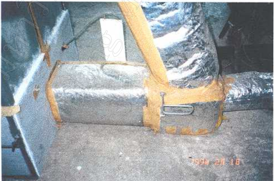
ภาพที่ 3.3 ท่อกระจายลมร้อนเข้าด้านล่างห้องบรรจุ
