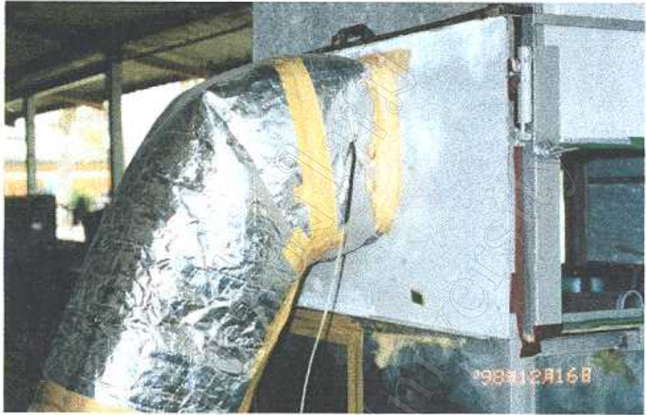
ภาพที่ 3.2 ท่อกระจายลมร้อนเข้าด้านบนห้องบรรจุ
