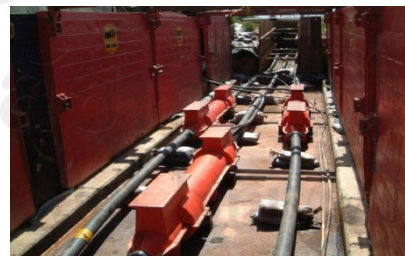
(d) internal view of joint bay
