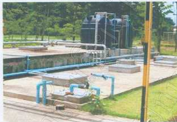
ภาพที่ 4-14 ระบบบำบัดน้ำเสีย (Wastewater System)
