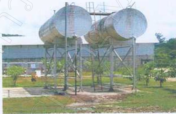
ภาพที่ 4-8 ถังเก็บน้ำมันเชื้อเพลิง (Fuel Oil Tank)
