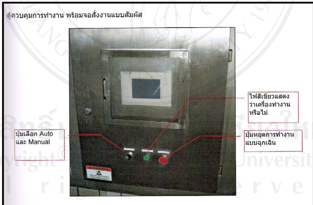
ภาพที่ 7 ตู้ควบคุมการทำงาน พร้อมจอสั่งงานแบบสัมผัส และปุ่มหยุดการทำงานแบบฉุกเฉิน
