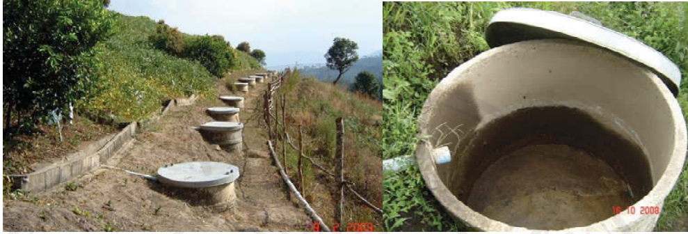
รูปที่ 3.13 ตำแหน่งการติดตั้งและลักษณะของถังวัดตะกอนดินขนาดเส้นผ่านศูนย์กลาง 100 ซม. และสูง 80 ซม. ตรงปลายส่วนล่างของทุกแปลงย่อยในแปลงทดลองที่ 1
