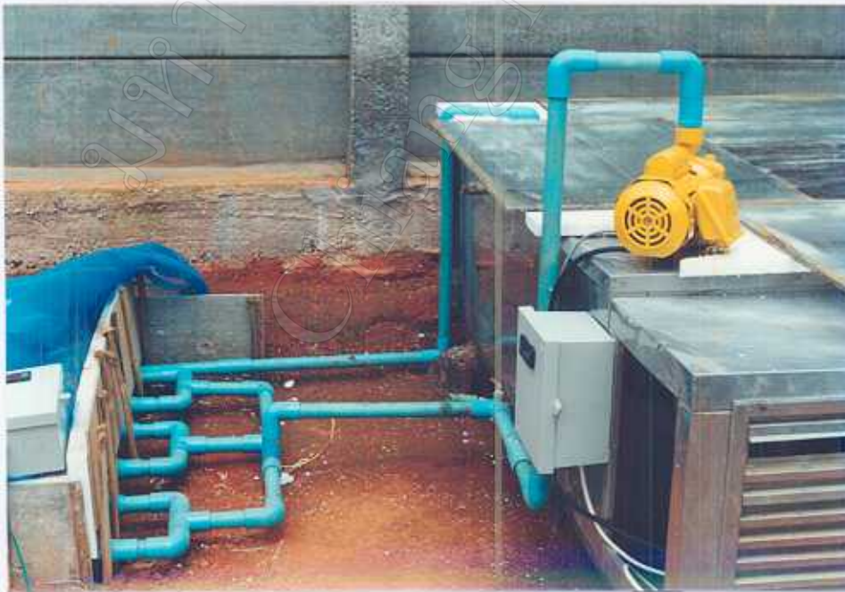
ภาพที่ 2 เครื่องควบคุมอุณหภูมิ น้ำ และระบบการวางท่อ
