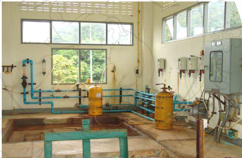
รูปที่ 4.9 แสดงโรงจ่ายสารเคมี
