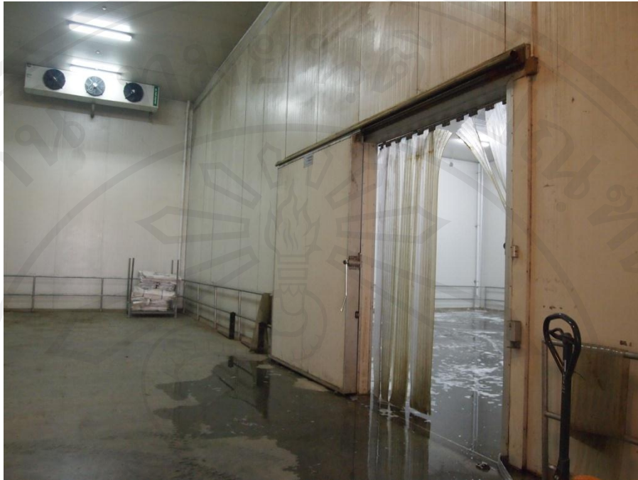
ภาพที่ ก-3 ลักษณะของห้องพักสินค้า (Anti-room) และประตูห้องเย็นที่มีม่านพลาสติก
